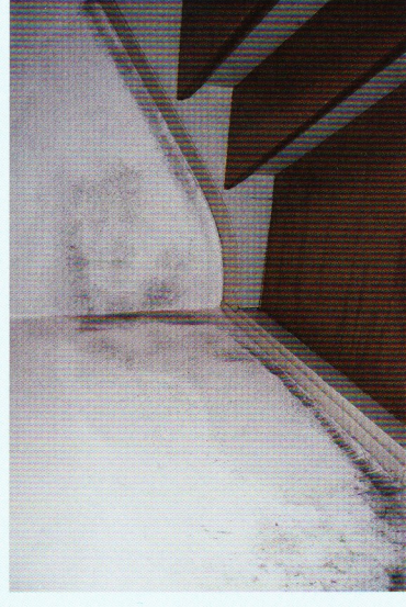
Schimmelbildung im Treppenbereich:
