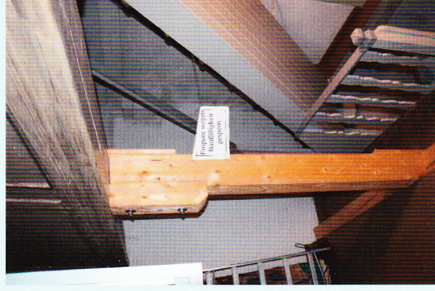
Notabstützung der Empore
